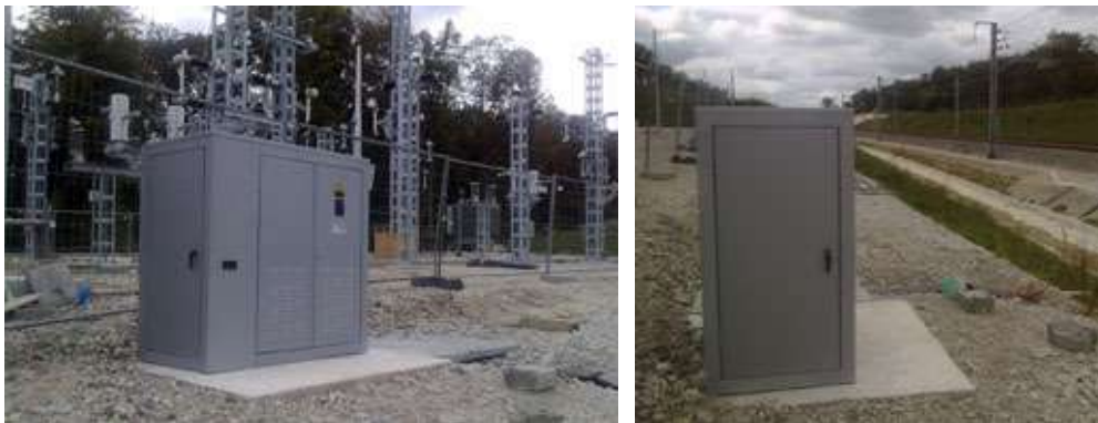
Armoire PTS32, RAL 9006, équipée d'un transformateur étanche IP68.
